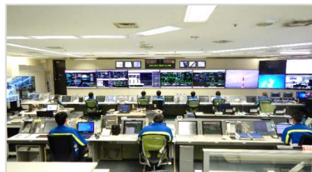
Central Control Room (Senboku LNG Terminal II)
