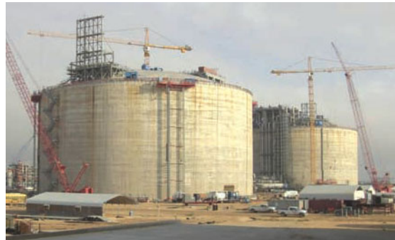
The Freeport LNG terminal
