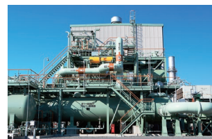
LNG cryogenic power generation facilities at Himeji LNG Terminal
