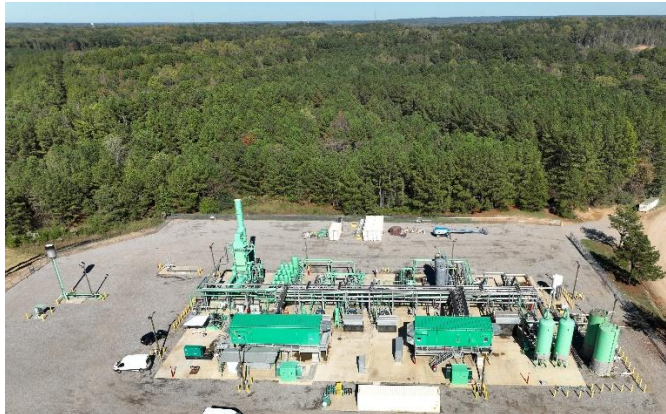
ゴミ埋立地由来バイオメタン 製造施設の様子 (Archaea Energy 提供)
