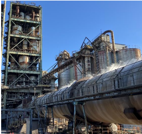
MUCC九州工場黒崎地区（セメント焼成用キルン・プレヒーター）
