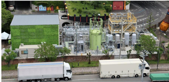
メタネーション実証設備の外観
