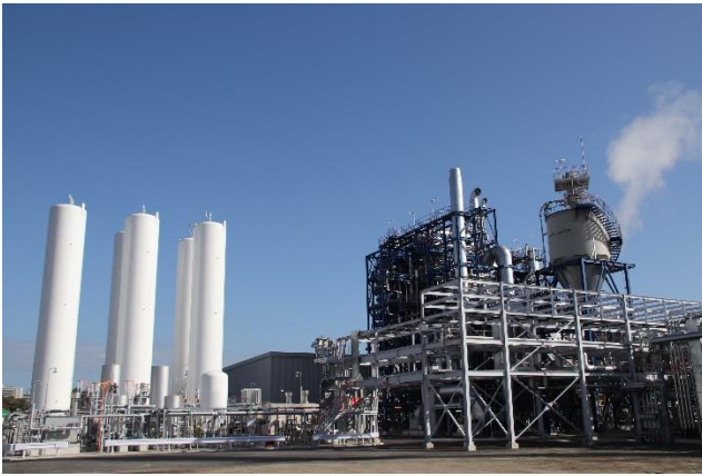
新設した火力発電所の外観
