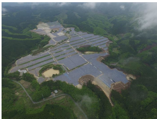
日立十王太陽光発電所（茨城県日立市）
