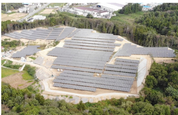
金成姉齒太陽光発電所
