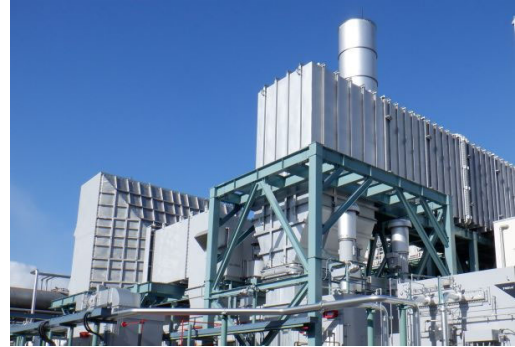
<高効率ガスタービン発電システム全景>
