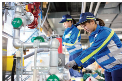
供給設備の安全点検の様子
