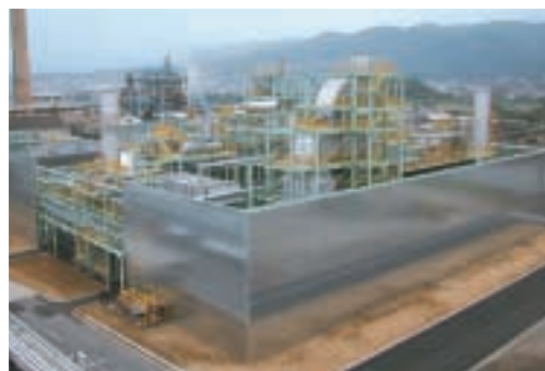
ユニチカ株式会社宇治事業所構内に建設された「電源コージェネレーションシステム」
