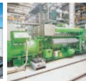
ガスコージェネレーションシステム
