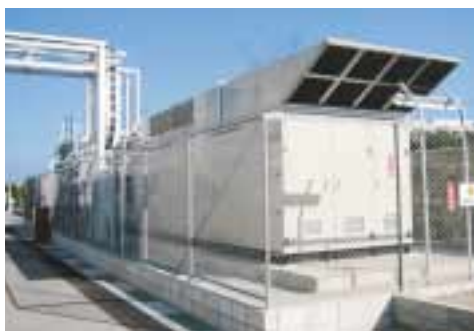
バイオガスを利用したコージェネレーションシステム
