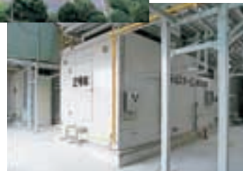
ガスコージェネレーションシステム
