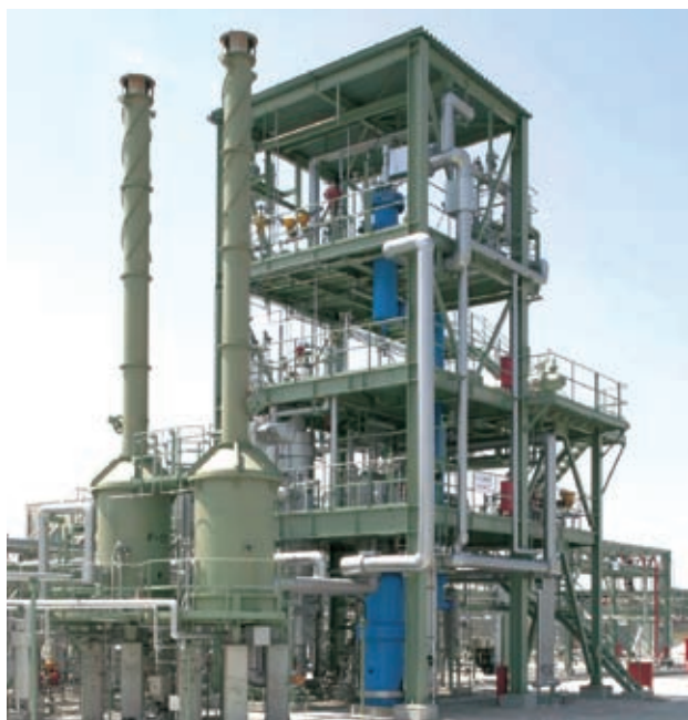
A-ATGパイロット装置 (実証装置)
