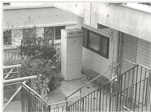
写真2 純水素駆動PEFCコージェネレーションの設置状況
