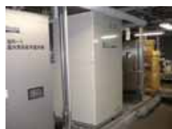
31KWガスエンジン コジェネ機
