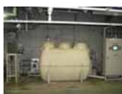
小型バイオガス化 装置
