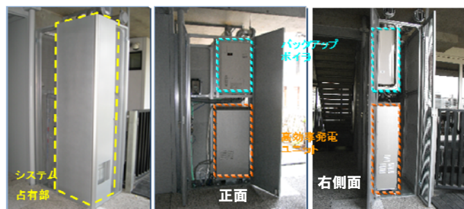
図5 高効率 SOFC 次世代コージェネ機(NEXT21 303 住戸)
