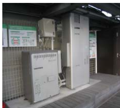
図3 燃料電池(SOFC)の設置状況（一例）
